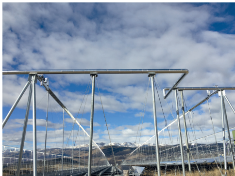
Centrale solaire de Llo en Cerdagne (SUNCNIM)
